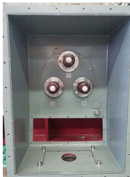
主接线盒内部
