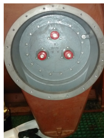
高压接线盒内部
