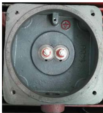
加热器接线盒内部
